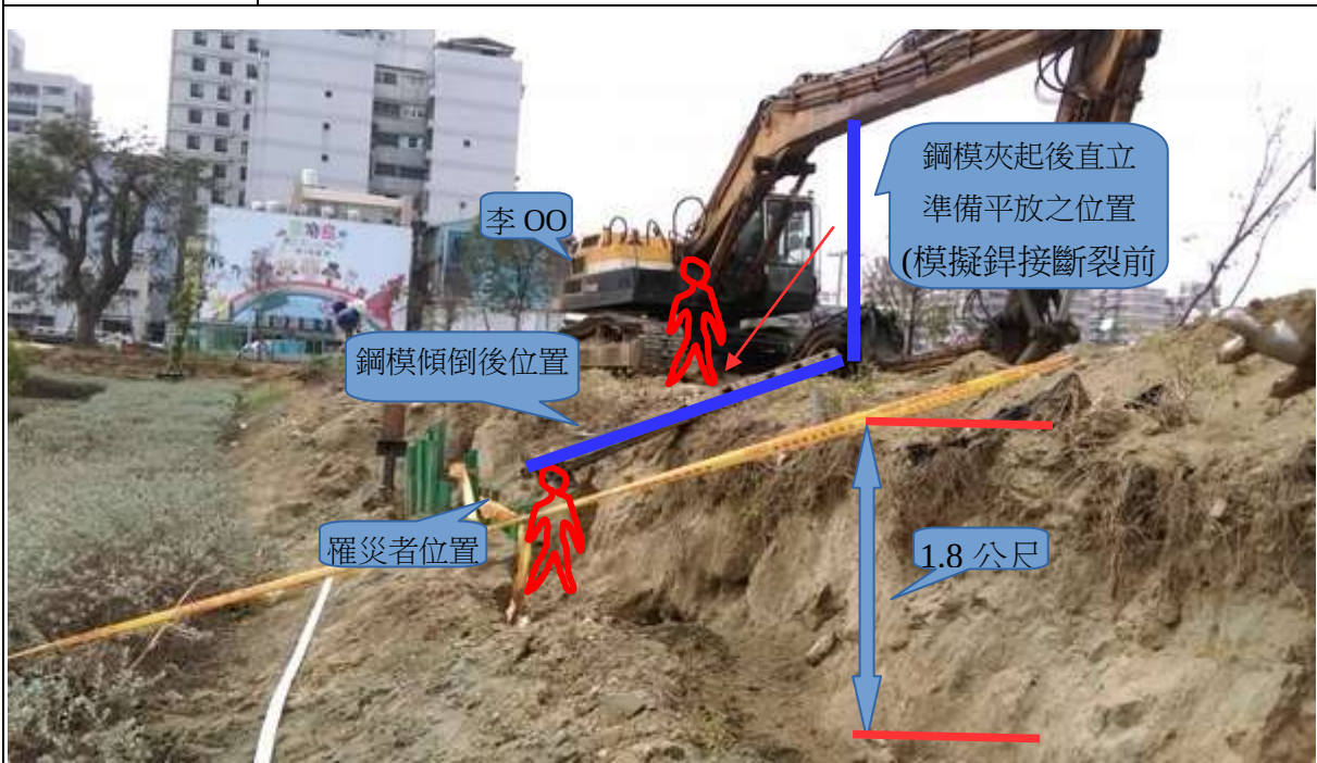
說明 照片二：罹災者蹲於打樁機右前方7公尺處，鋼模與樁頭鉚接處斷裂後，鋼模朝罹災者方向倒下，擊中罹災者頭部。
