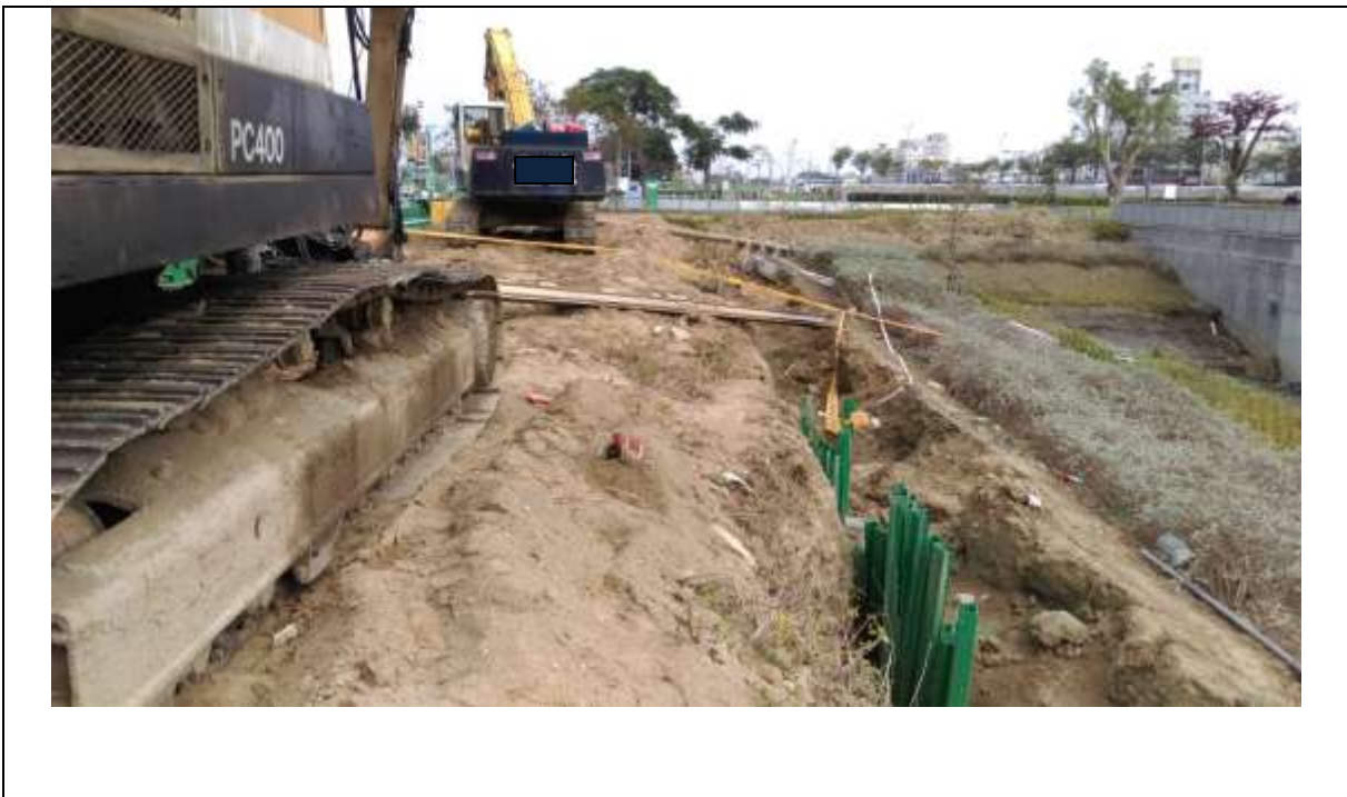
說明 照片一：災害發生於台南市東區「○○改善工程」塑鋼板樁打設作業處。
