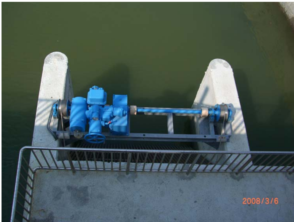
說明：東石抽水站(欄污柵用)
