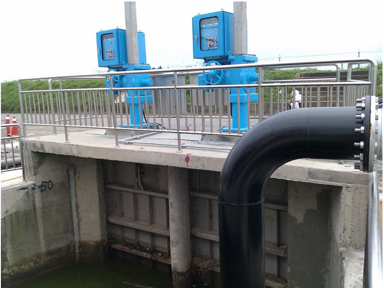
說明：高雄永安抽水站
