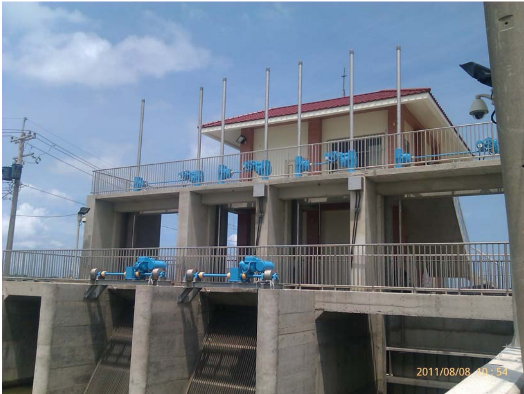
說明：新塭抽水站
