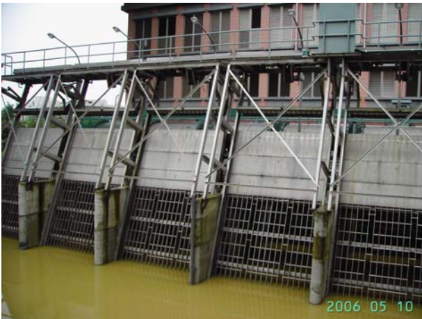
說明：民權抽水站鋼索式撈污機
