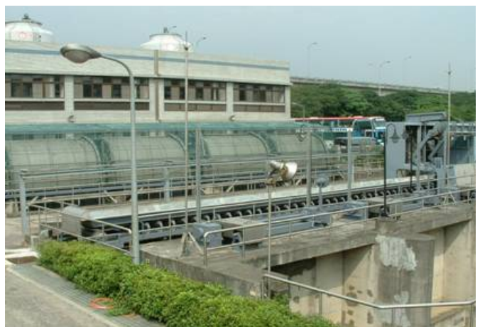
說明：濱江抽水站迴轉式撈污機
