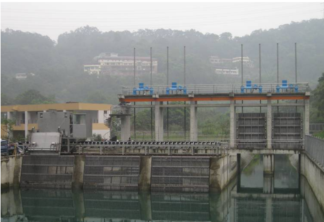
說明：第二原水抽水站行走式撈污機
