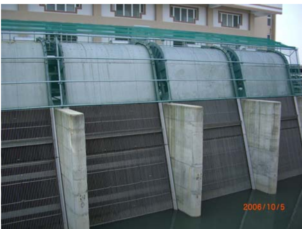
說明：中和第二抽水站迴轉式撈污機
