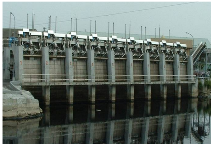
說明：蘆洲抽水站鋼索式撈污機
